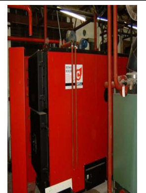
320Kw Compte Chip Boiler
